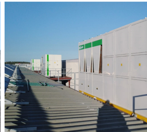
BIMBO | Córdoba, Spanien Dachanlagen KCR
