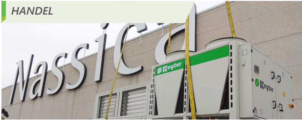
KIWOKO NASSICA | Getafe, Spanien Dachanlagen KCR
