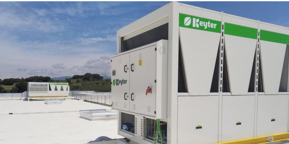
PICKING FARMA | Barcelona, Spanien Dachanlagen KCR
