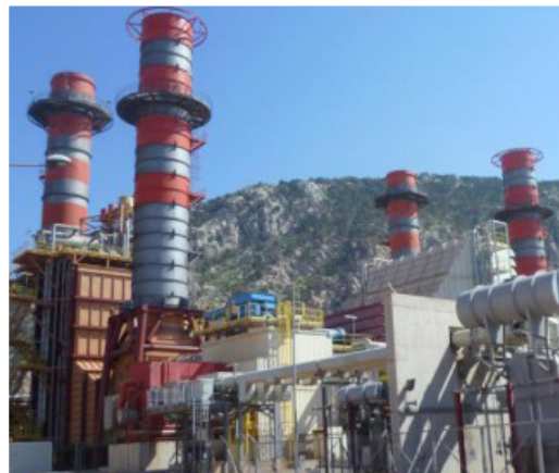
GENERAL ELECTRIC Wärmekraftwerk | Agios Nikolaos, Griechenland Dachanlagen KCR & Komplettsysteme KCV
